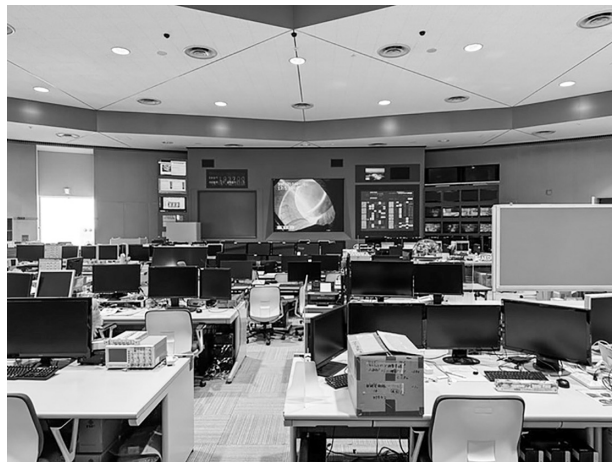
写真 1 制御室の様子
