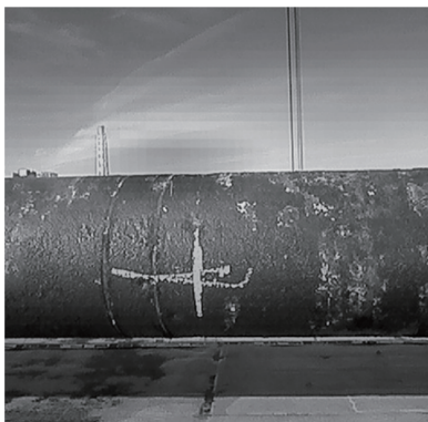
図 11 SGTS 配管（1 m位置）での詳細撮影
