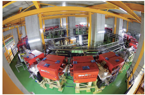
図2 RIビームファクトリー施設に建設された稀少RIリング 赤色の双極電磁石24台により構成されている
