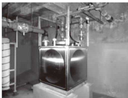
写真1 ピット内部の集合槽（排水設備の標識は反対側に掲示）
