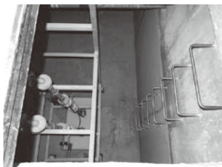
図5 管理区域内に設置された排水施設ピット 定期点検の時などに、少々苦勞する場合がある
