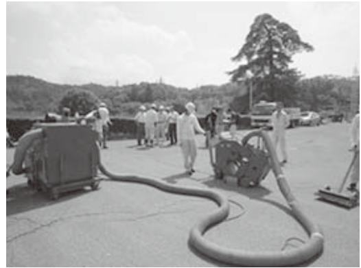
図 1 ブラストによる剥離
